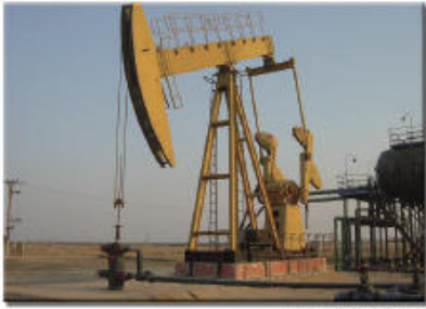
油田採油設備
