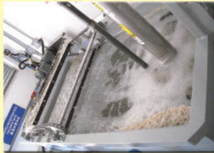
氣浮缸的運作情況
