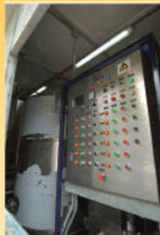
污水回用系統安裝於赤徑郊區公廁
